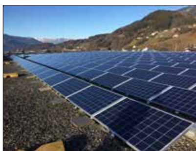
PV-Anlage auf dem Dach der MMS-Thüringen
