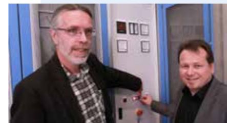
Mit einem symbolischen Knopfdruck wurde das Kraftwerk Schwarzbach von Bgm. Harald Witwer und Projektmotor Werner Madlener in Betrieb genommen.
